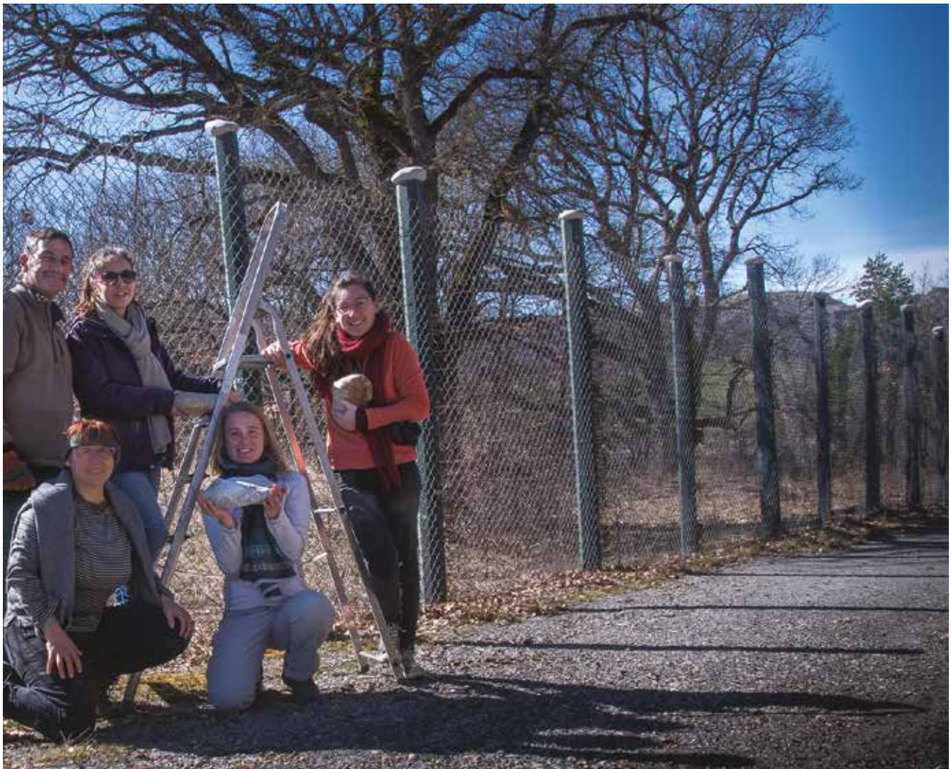
Opération de rebouchage de poteaux électriques sur le site de l'Adoux des Faïsses (04) pour protéger la faune sauvage
