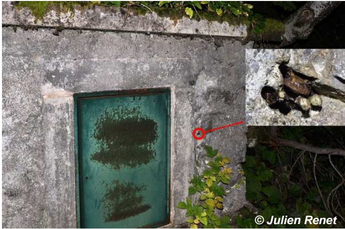
Figure 12 : Infrastructure hydraulique, forêt communale de la Brigue – La Brigue, Alpes-Maritimes. © Julien Renet
