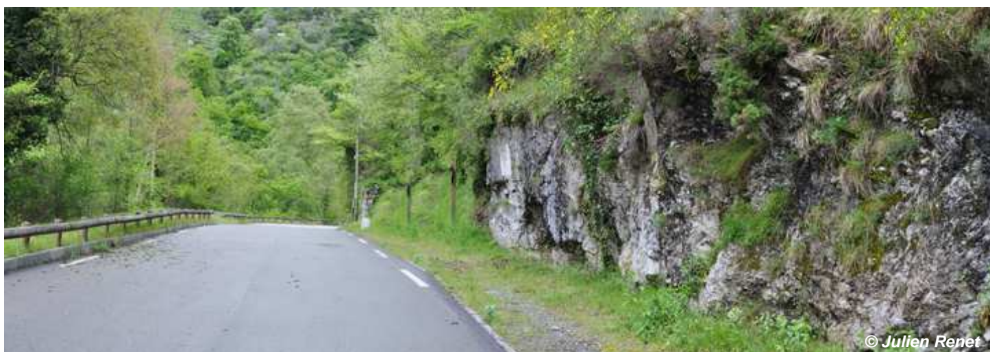
Figure 18 : Paroi rocheuse de bord de route – Saorge, Alpes-Maritimes. © Julien Renet
