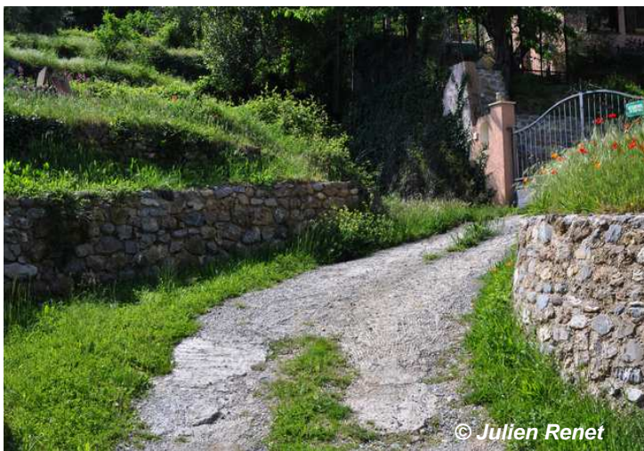
Figure 16 : Muret de soutènement, propriété privé – Breil/Roya, Alpes-Maritimes. © Julien Renet
